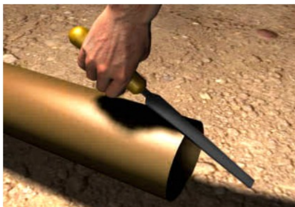
Figura 9 – Preparo da ponta (A ponta resultante do corte do trecho danificado deverá ser chanfrada com auxílio de uma lima).
