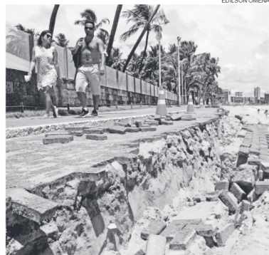
Trecho na orla de Jatiúca é outro que registra o problema de erosão
