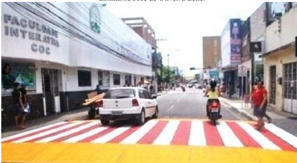
Figura 7. Pintura da faixa de travessia de pedestres defronte à Escola Rosa Mística, Rua Estudante José de Oliveira Leite.
